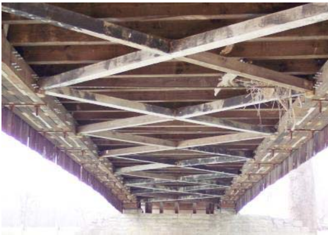
Κάτω από την Γέφυρα, τα κατακόρυφα Μεταλλικά Μέλη τρυπούσαν τις Ξύλινες Δοκούς του κάτω Πέματος και βιδώνονταν επάνω τους
