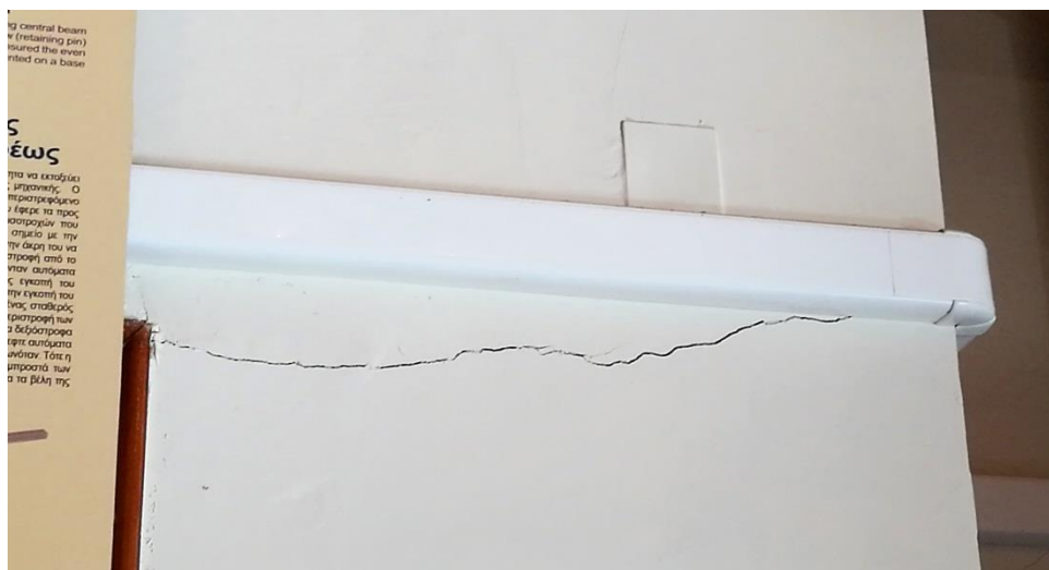
Εικόνα 15 Τοίχος εσωτερικά στο Μουσείο με μεγάλη ρωγμή
