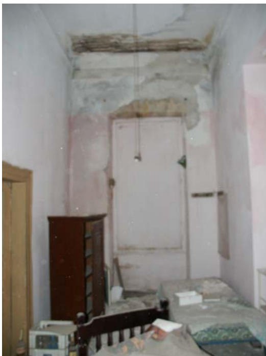
Εικόνα Ι/88 Όψη του τοίχου ΑΒ. Έκδηλα και εδώ τα σημάδια εγκατάλειψης.
