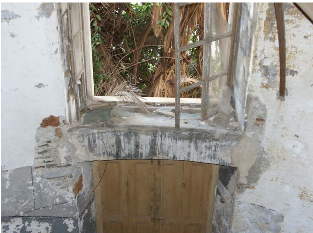
Εικόνα Ι/113 Τα παράθυρα που υπάρχουν στον καμπύλο τοίχο της μαρμάρινης σκάλας. Βλέπουμε ότι έχει υποστεί σοβαρή φθορά με αποτέλεσμα να εισέρχονται τα νερά της βροχής.
