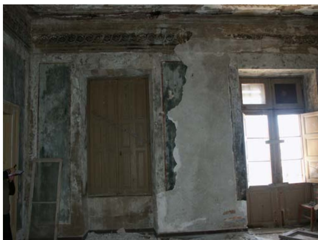
Εικόνα I/72 Το αριστερό μέρος του τοίχου ΑΔ. Έχει καταπέσει μεγάλο μέρος της ζωγραφική αλλά και της προετοιμασίας, λόγω υγρασίας που εισέρχεται μέσω του τοίχου, από τις φθαρμένες υδρορροές που βρίσκονται σε εκείνο το σημείο εξωτερικά.
