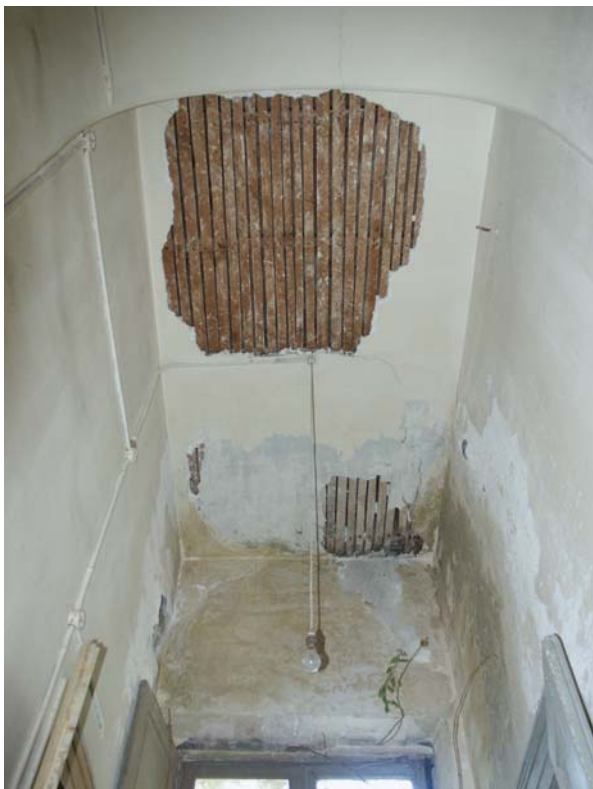
Εικόνα Ι/104 Η οροφή του δωματίου-χολ, παρατηρούμε την επίδραση της υγρασίας και τις απώλειες που έχει σαν αποτέλεσμα.
