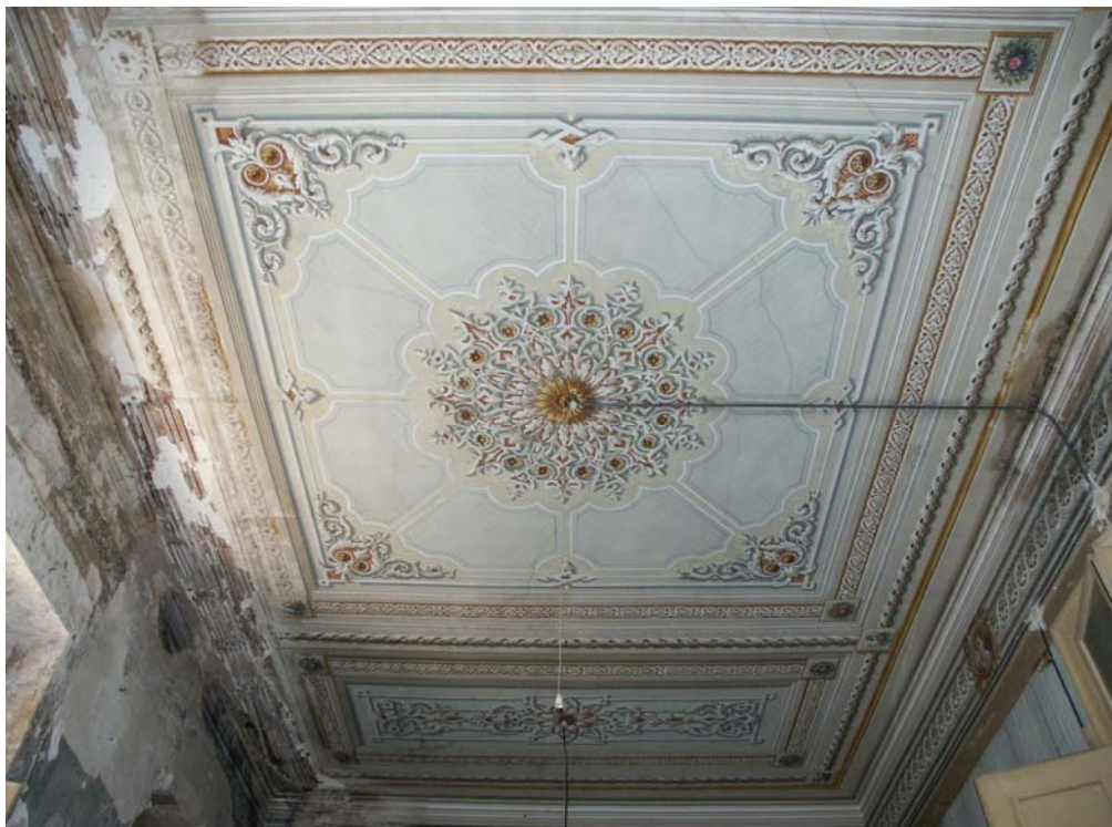
Εικόνα Ι/68 Άποψη της οροφής του δωματίου. Διακρίνεται το καλώδια εγκατάστασης ρεύματος. Β
