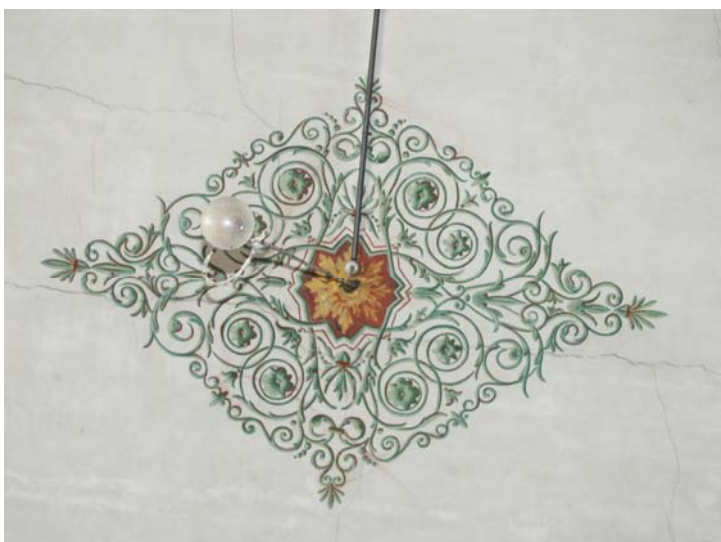
Εικόνα Ι/96 Το κεντρικό δαικοσμητικό στοιχείο της οροφογραφίας. Παρατηρούμε και τις εγκαταστάσεις ηλεκτρικού.
