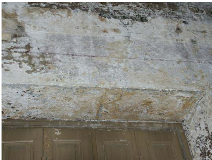
Εικόνα 6/20 Άποψη από τον τοίχο του δωματίου 4 στο ισόγειο . Παρατηρούμε την λευκή κρούστα που έχει σχηματιστεί στην
