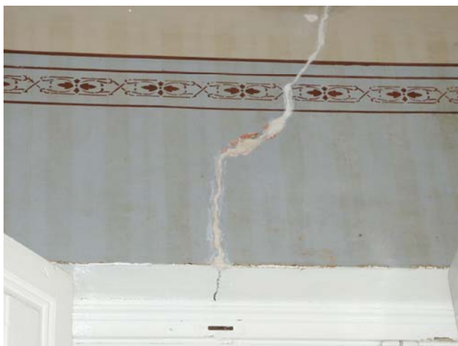
Εικόνα Ι/26 Ρωγμή που έχει στοκαριστεί.
