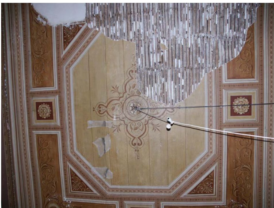
Εικόνα Ι/50 Άποψη του τμήματος που έχει καταπέσει και φαίνεται το μπαγδατί
