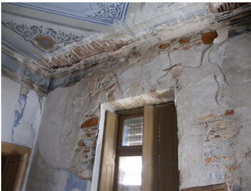
Εικόνα Ι/65 Τοίχος ΔΑ, παρατηρούμε την ανομοιομορφία , λόγω καταπτώσεων, της ζωγραφικής επιφάνειας. Επίσης μπορούμε να διακρίνουμε και τα ξύλα του μπαγδατί.
