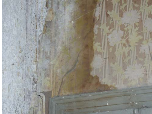
Εικόνα Ι/41 Ρωγμή επάνω από την πόρτα στον τοίχο ΑΒ
