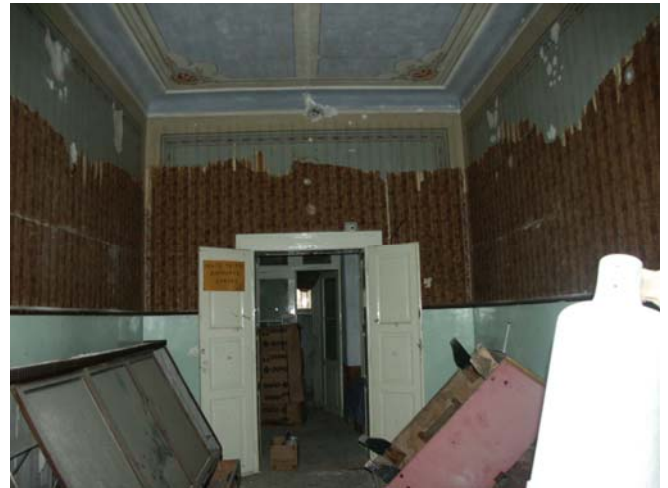
Εικόνα Ι/23 Ο τοίχος με την είσοδο του δωματίου, διαφαινόνται τα επάλληλα στρώματα ταπετσαρίας και τα διάσπαρτα αντικείμενα, σημάδι μακρόχρονης εγκατάλειψης. Τοίχος ΒΓ
