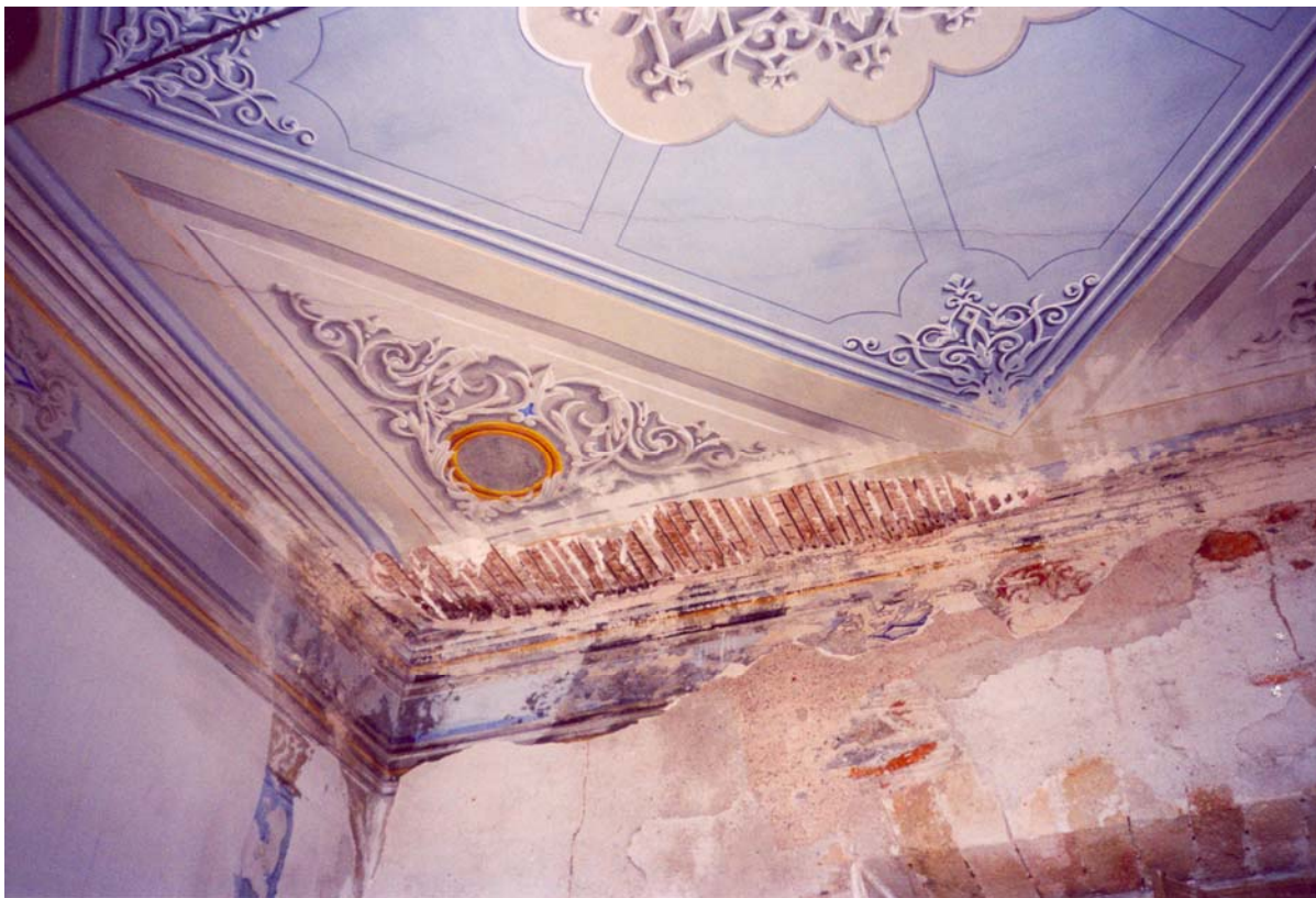
Εικόνα Ι/66 Λεπτομέρεια της φθοράς από υγρασία, στην οροφή του δωματίου. Όψη ΑΔ
