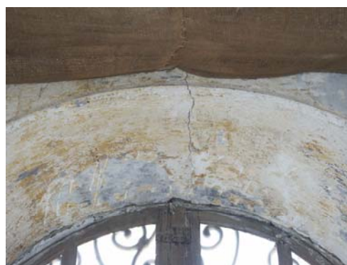
Εικόνα 6/29 Ρωγμή στην καμάρα επάνω από το κάσωμα στο παράθυρο του δωματίου 9 στο
