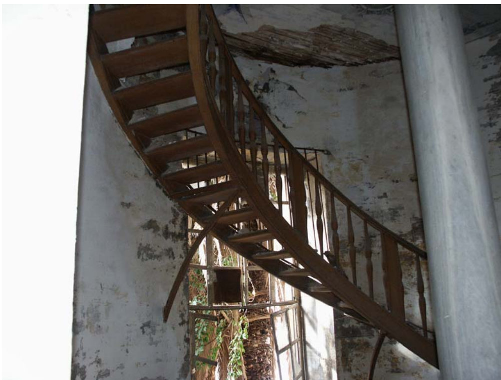
Εικόνα Ι/112 Βλέπουμε τις απώλειες ζωγραφικής επιφάνειας, εξαιτίας των νερών της βροχής, και την ξύλινη σκάλα που οδηγεί στην στέγη.
