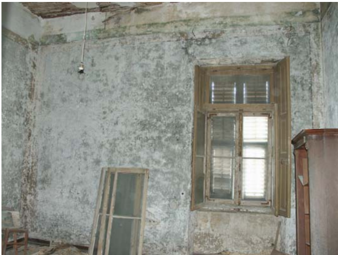
Εικόνα 6/2 Τοίχος από το δωμάτιο 3 του ορόφου. Διακρίνεται εύκολά η αποσαθρωμένη επιφάνεια του τοίχου.
