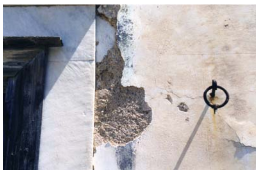
Εικόνα 6/22 Ρωγμές και αποκολλήσεις στο εξωτερικό του κτιρίου δίπλα από το κάσωμα της μπαλκονόπορτας στο όροφο.
