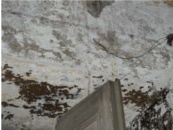
Εικόνα 6/6 Μέρος τοιχογραφίας από το δωμάτιο 5 του ισογείου. Διακρίνουμε ότι επάνω από το παράθυρο , που δεν έχει τοποθετηθεί ταπετσαρία , το χρωματικό στρώμα αποφλοιώνεται.
