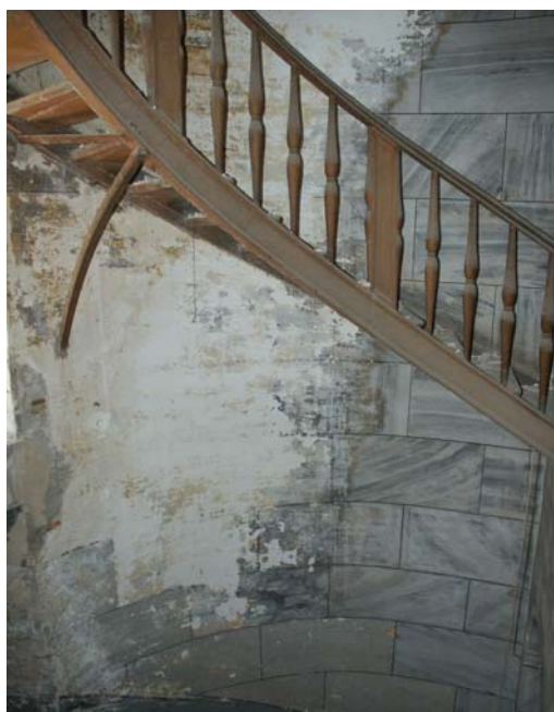
Εικόνα 8/3 Απώλεια χρωματικού στρώματος στην περιοχή της σκάλας.
