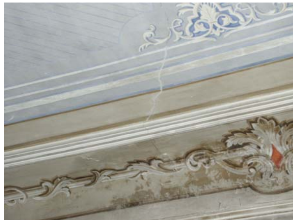
Εικόνα Ι/17 Λεπτομέρεια διακοσμητικού στοιχείου από το τραχήλωμα. Διαφαίνεται μια λεπτή ρωγμή.
