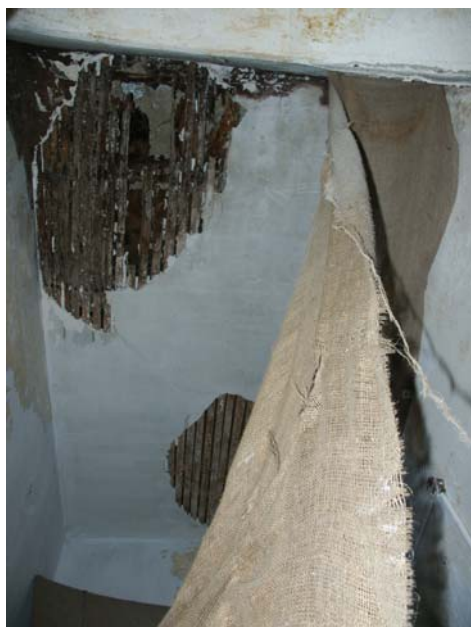
Εικόνα I/51 Η οροφή του δωματίου. Διακρίνουμε τις μεγάλες φθορές λόγω υγρασίας. Επίσης βλέπουμε το κομμάτι ύφασμα που κάλυπτε την οροφή, πιθανόν να υπήρχα φόβος πτώσεων σοβά.
