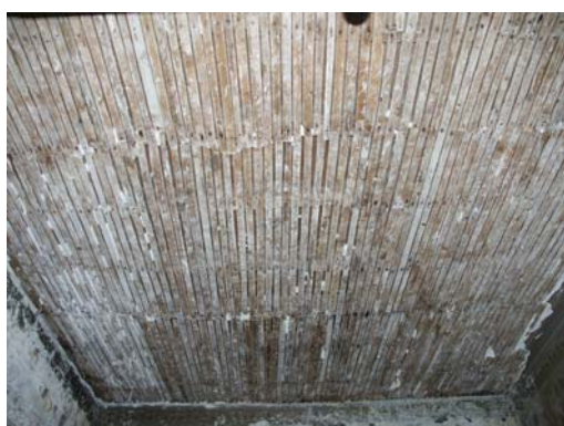
Εικόνα 8/1 Παρατηρούμε ότι έχει χαθεί στο σύνολό της η οροφογραφία. Διακρίνεται καθαρά το μπαγδατί. Δωμάτιο 5 ισόγειο.
