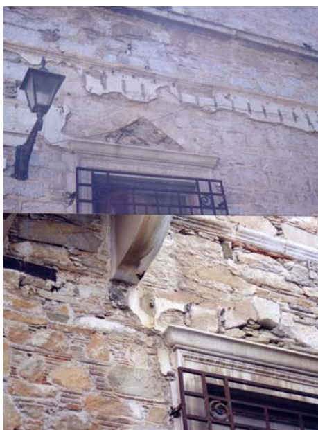
Εικόνα Ι/117 Εικόνες εξωτερικά του κτιρίου όπου βλέπουμε να έχει καταπέσει ο σοβά και να φαίνεται πλέον η τοιχοποιία, το υποστήριγμα δηλαδή των τοιχογραφιών.
