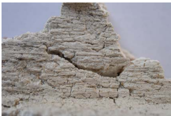
Εικόνα Ι/136 Διακρίνουμε την φθορά που έχει υποστεί το κονίαμα.
