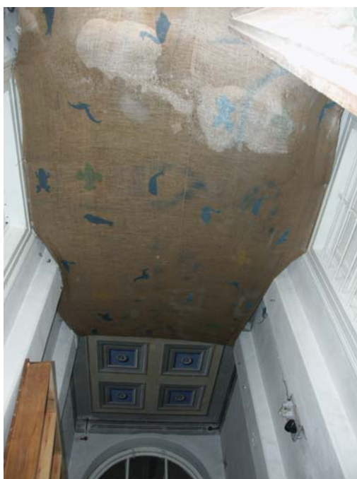
Εικόνα Ι/31 Άποψη της οροφής. Βλέπουμε ότι είναι καλυμμένο το μεγαλύτερο της μέρος, ίσως για την αποφυγή ατυχήματος από καταπτώσεις της οροφογραφίας.
