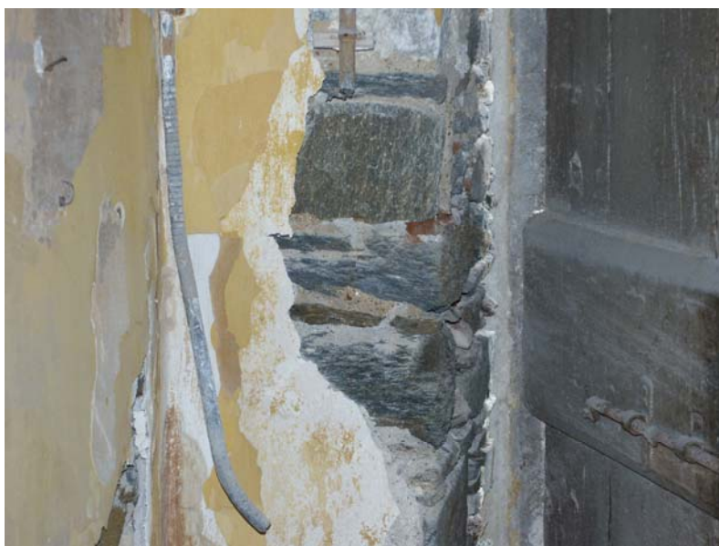
Εικόνα Ι/58 Έχει καταπέσει κομμάτι υποστρώματος δίπλα από την πόρτα του δωματίου, και έτσι μπορούμε να δούμε την τοιχοποιία, δηλαδή το υποστήριγμα.
