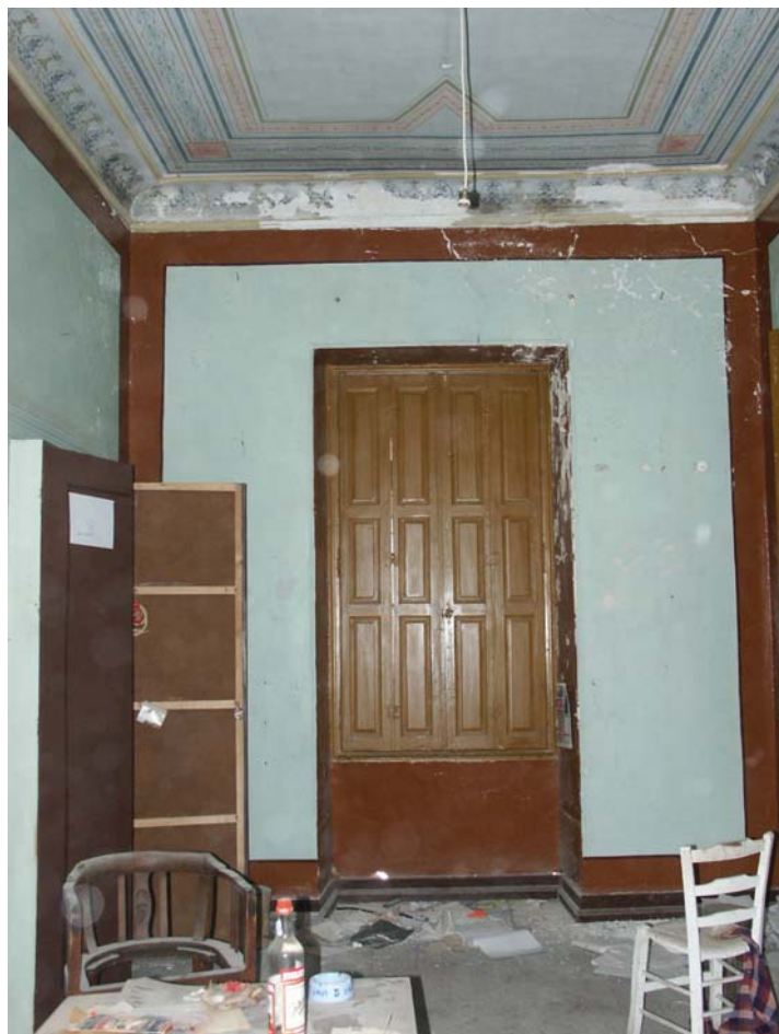
Εικόνα Ι/33 Τοίχος ΔΑ
