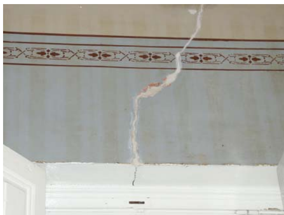
Εικόνα 7/7 Ρωγμή η οποία έχει στοκαριστεί σε κάποια παλαιότερη επέμβαση, και επιβάλλεται να ξαναστοκαριστεί με τον τρόπο που αναφέρεται.
