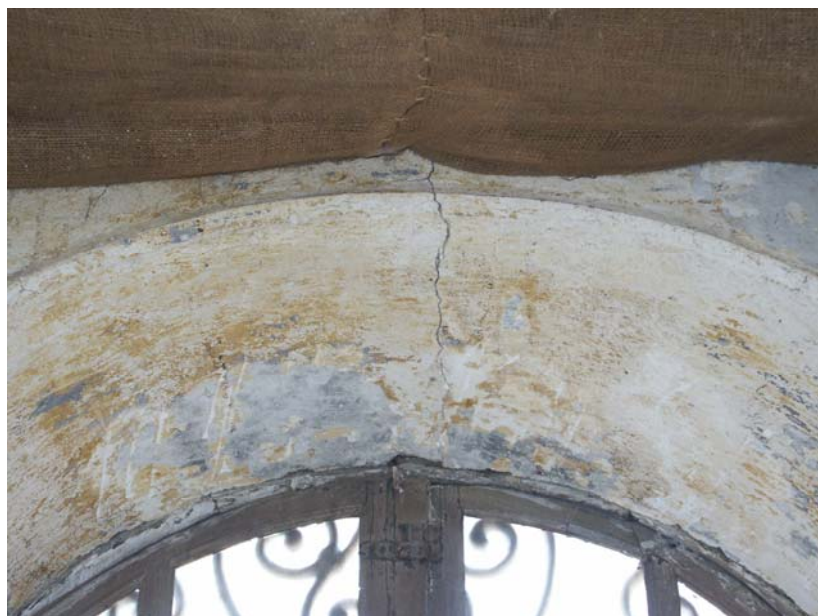
Εικόνα I/52 Ρωγμή στην καμάρα επάνω από το παράθυρο του δωματίου.
