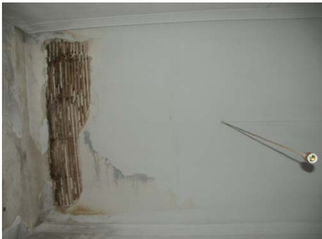
Εικόνα Ι/86 Παρατηρούμε τα σημάδια υγρασίας στην οροφή του δωματίου. Διακρίνουμε και το μπαγδατί
