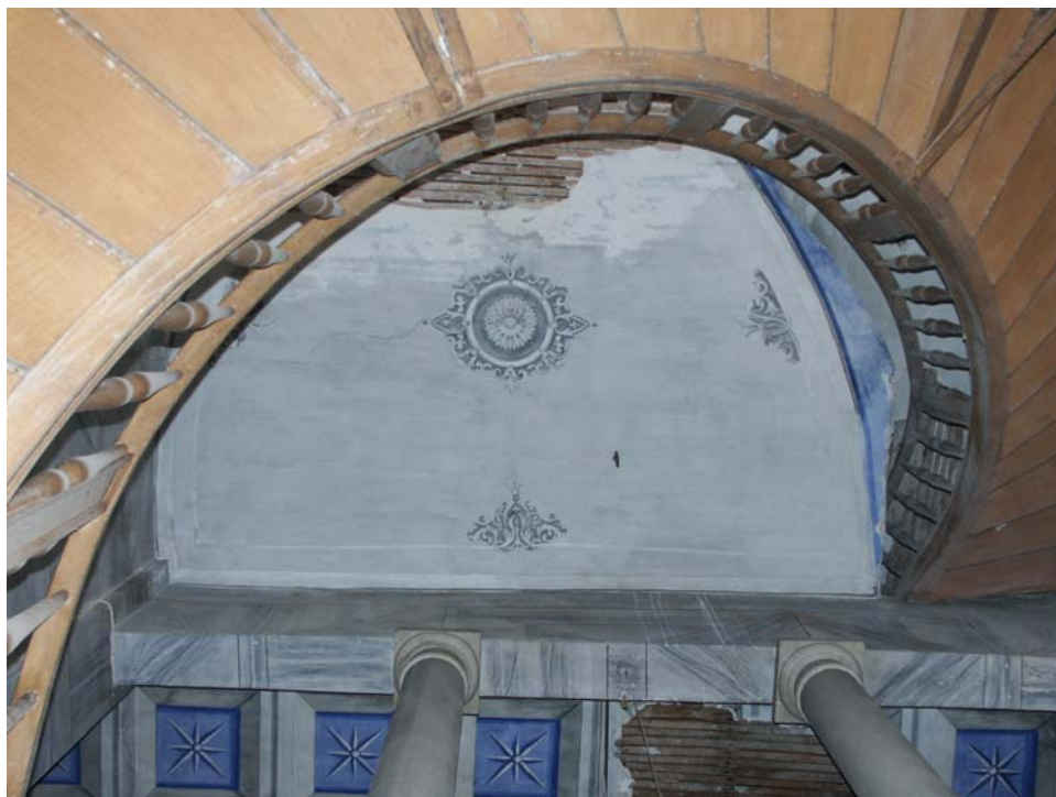
Εικόνα Ι/107 Η οροφोगραφία που φιλοξενείται επάνω από την σκάλα. Βλέπουμε ότι έχει καταπέσει και ένα μέρος της εξαιτίας της υγρασίας.
