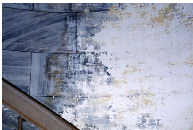
Εικόνα I/54 Άποψη της απομίμησης ορθομαρμάρωσης. Διακρίνουμε την πολύ μεγάλη σε έκταση, αποσάθρωση της ζωγραφικής επιφάνειας λόγω υγρασίας που προκαλείται από τα νερά της βροχής, τα οποία μπαίνουν από τις φθορές της στέγης, και του παραθύρου.
