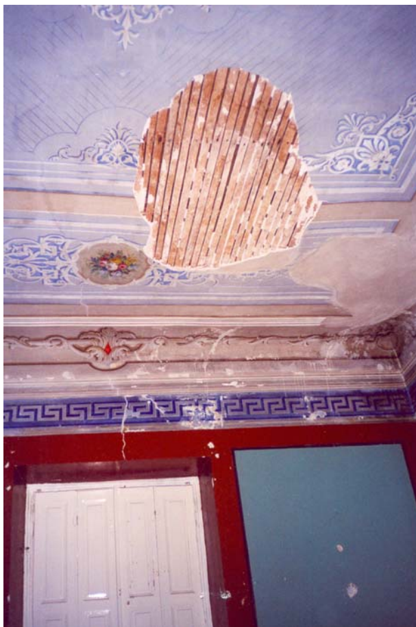
Εικόνα Ι/20 Διακρίνουμε το κομμάτι οροφोगραφίας που έχει καταπέσει και τα επίθετα χρώματα που έχουν επιζωγραφιστεί με την μορφή πλαισίων. Προσανατολισμός ΑΒ
