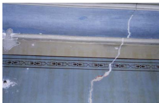
Εικόνα6/23 Ρωγμή στο τραχύλωμα και στον τοίχο του δωματίου 1 στο ισόγειο
