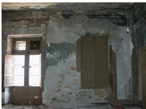
Εικόνα 8/2 Απώλεια χρωματικού στρώματος δωμάτιο 2 όροφος.
