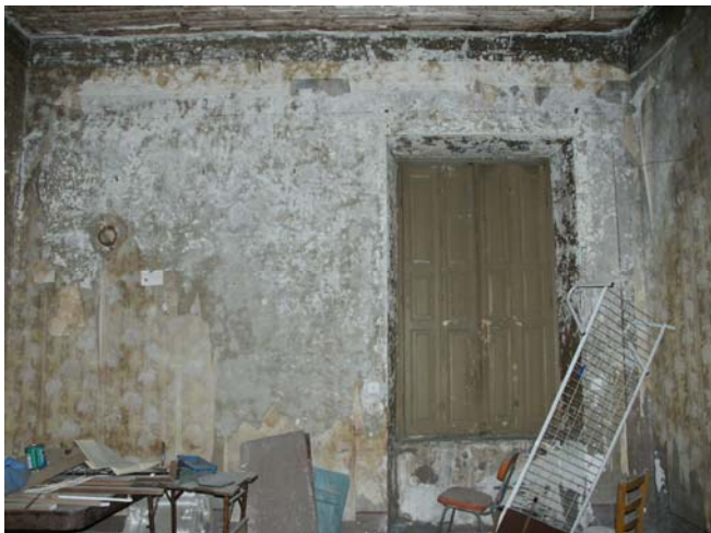
Εικόνα Ι/39 Τοίχος ΓΔ, Διακρίνουμε τα σημάδια αποσάθρωσης της ταπετσαρίας και αποφλοιώσεις του επίθετου χρώματος επάνω από το παράθυρο
