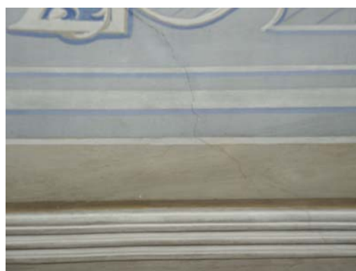
Εικόνα6/25 Ρωγμή στην οροφή
