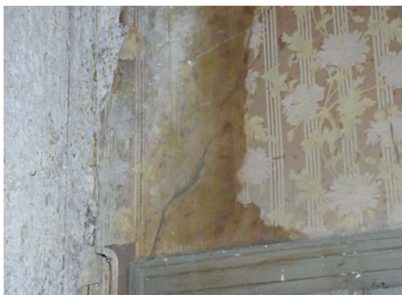
Εικόνα 6/28 Ρωγμή επάνω από το κάσωμα στο δωμάτιο 5 του ισογείου
