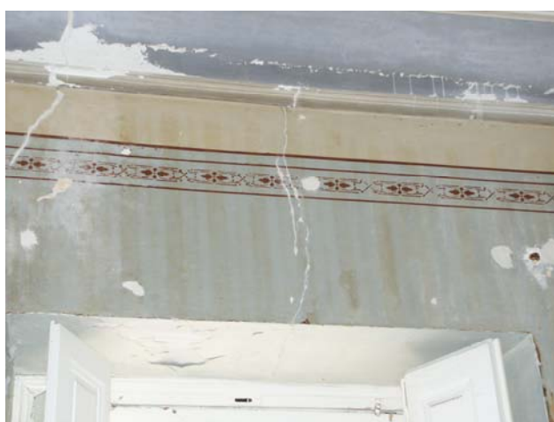
Εικόνα Ι/28 Στοκαρισμένες ρωγμές και μικρές απώλειες στο τραχήλωμα
