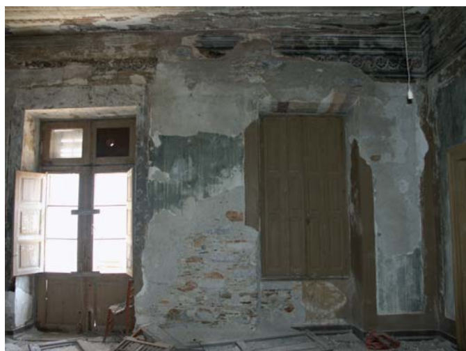
Εικόνα I/73 Το δεξί μέρος του τοίχου ΑΔ. Έχει καταπέσει μεγάλο μέρος της ζωγραφική αλλά και της προετοιμασίας, λόγω υγρασίας που εισέρχεται μέσω του τοίχου, από τις φθαρμένες υδρορροές που βρίσκονται σε εκείνο το σημείο εξωτερικά.
