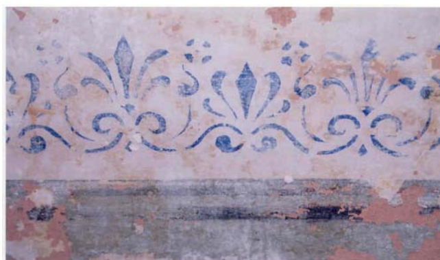
Εικόνα Ι/103 Διακοσμητικό στοιχείο στο ύψος του πασαμέντο, το οποίο βρίσκεται σε στρώμα που καλύπτεται από πλαστικό χρώμα.
