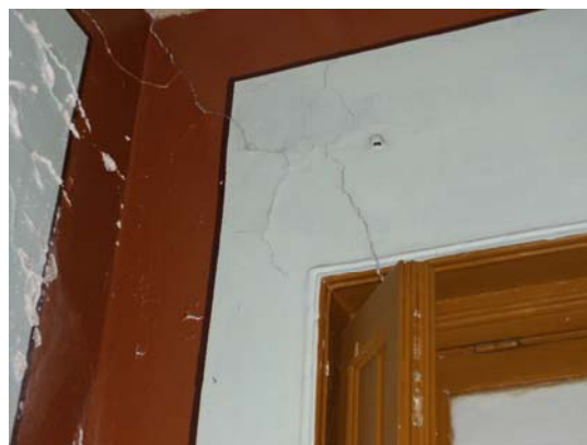
Εικόνα 6/27 Ρωγμή επάνω από το κάσωμα πόρτας στο δωμάτιο 4 του ισογείου
