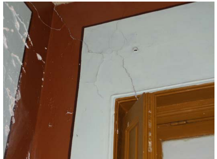
Εικόνα Ι/36 Ρωγμές επάνω από το παράθυρο του τοίχου ΑΒ
