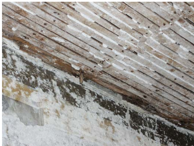
Εικόνα Ι/43 Αποσάθρωση και αφλοίωση του χρωματικού στρώματος λόγω υγρασίας. Φαίνεται επίσης το μπαγδατί.
