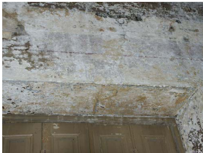
Εικόνα Ι/42 Αποσάθρωση και αφλοίωση του χρωματικού στρώματος λόγω υγρασίας.
