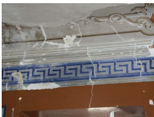
Εικόνα 6/24 Διακρίνουμε ρωγμές σε τοίχο και οροφή του δωματίου 1 του ισονείου
