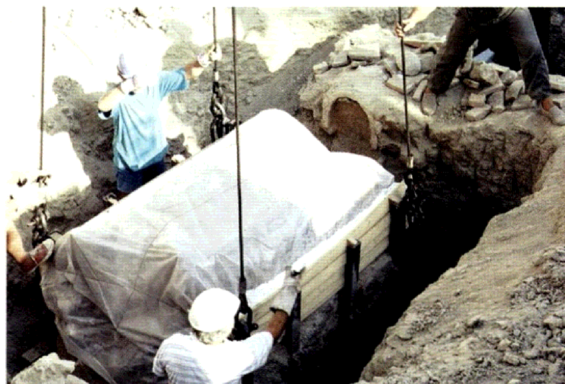
Απόσπαση τμήματος του υδραγωγείου.
